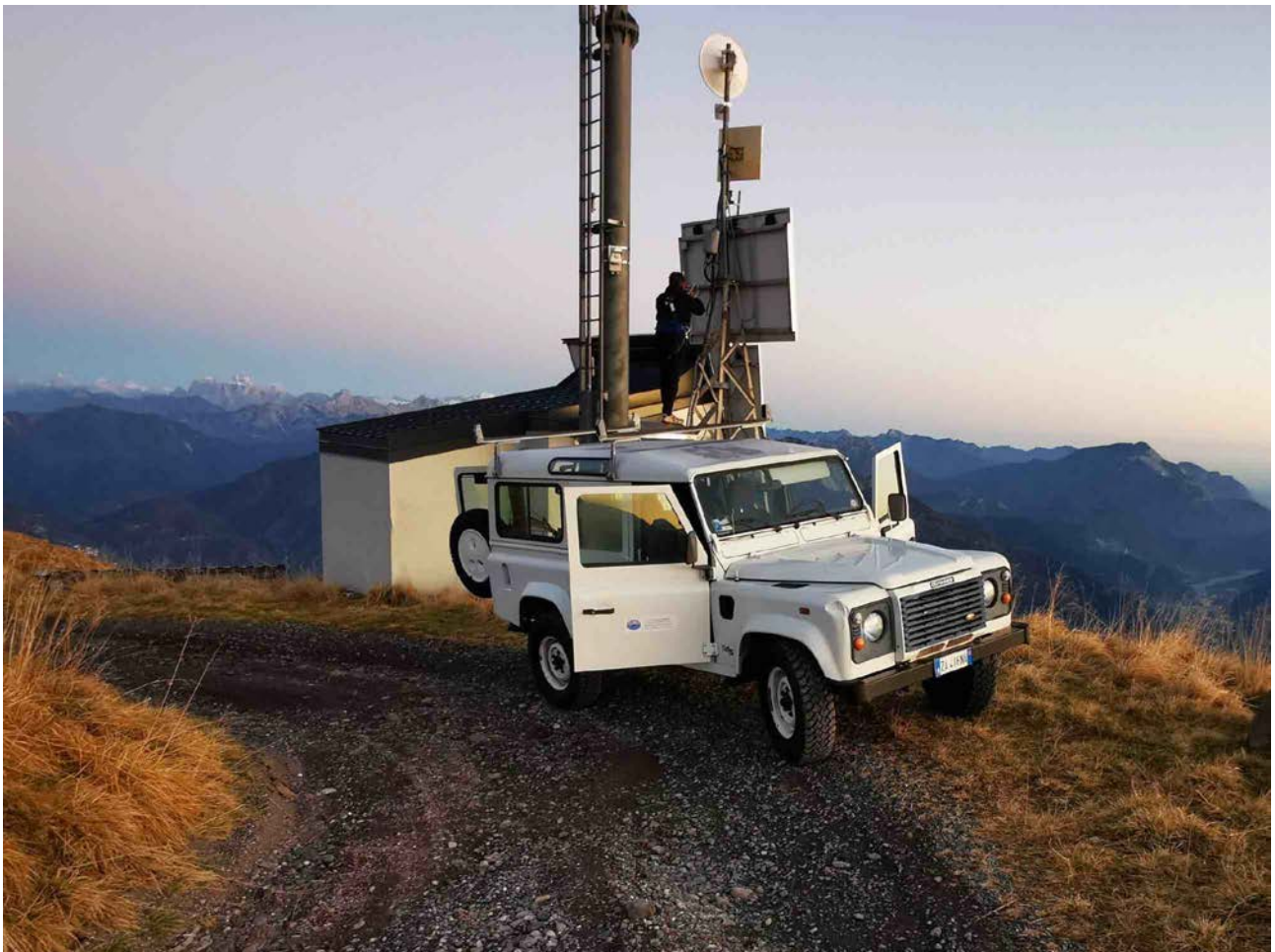
Stazione di monitoraggio della rete SMINO installata sullo Zoufplan.
