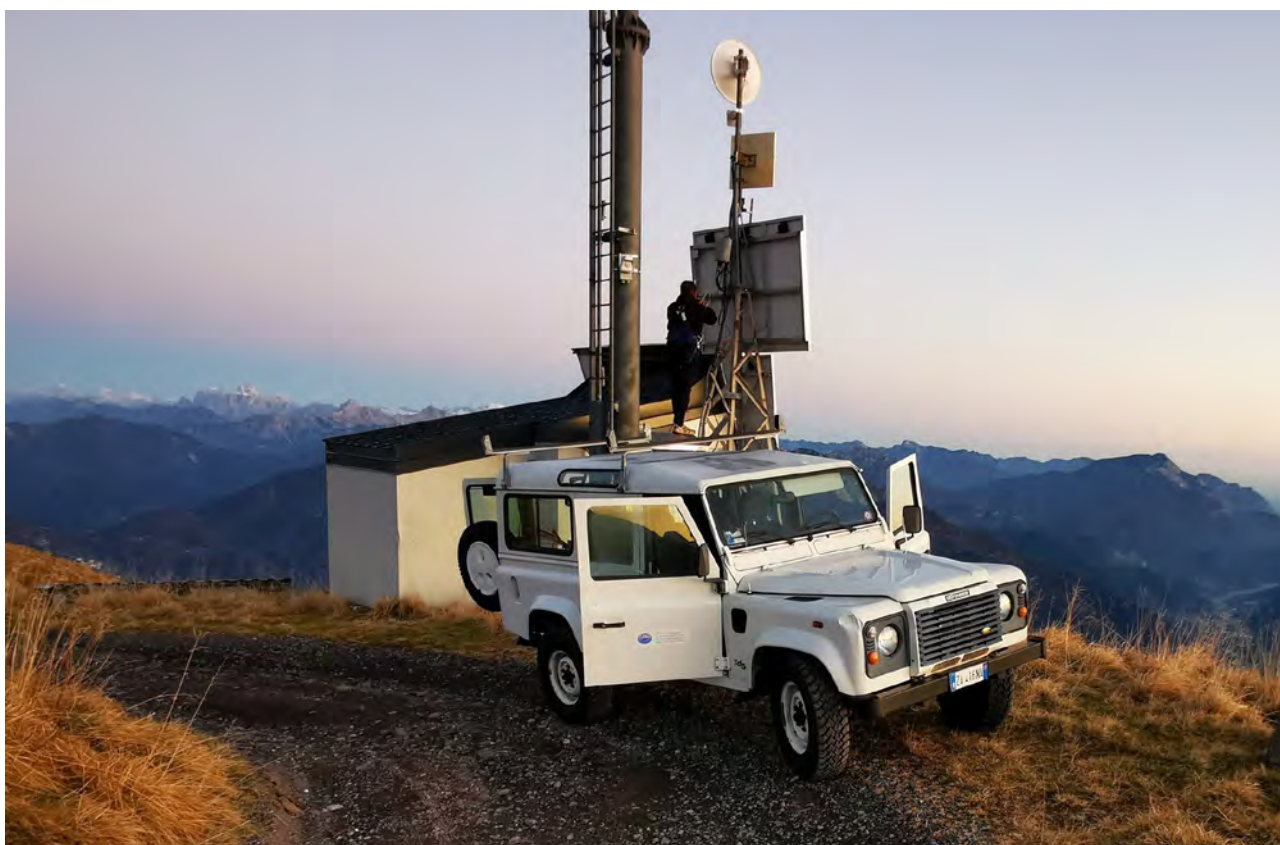
Stazione di monitoraggio della rete SMINO installata sullo Zoufplan.
